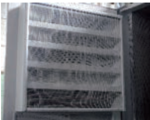
进排风口防护装置
